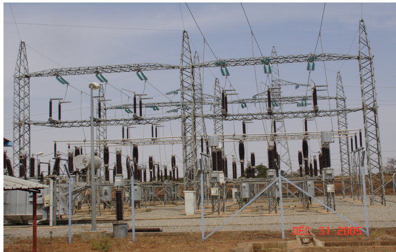
EQUIPEMENTS HAUTE TENSION DU POSTE DE ZANO
